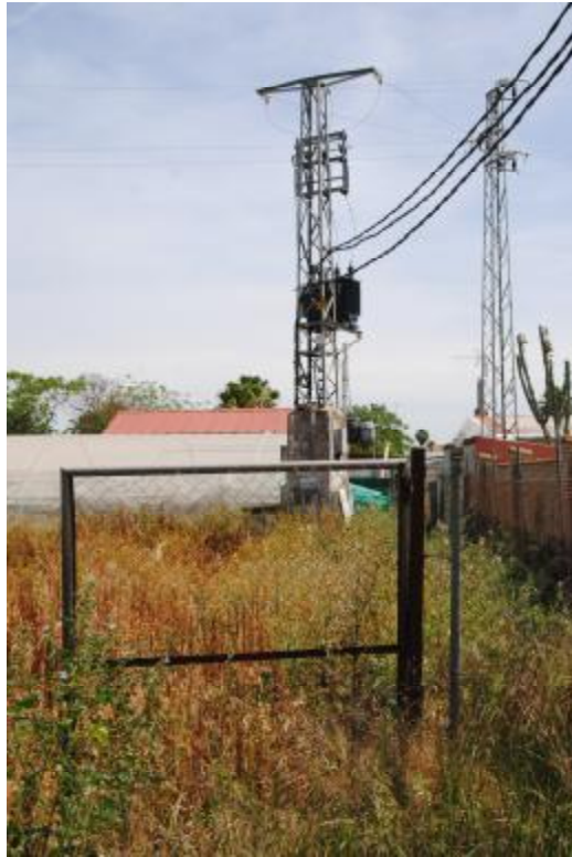
Foto 2. Centro de Transformación. Posible punto de suministro eléctrico.
